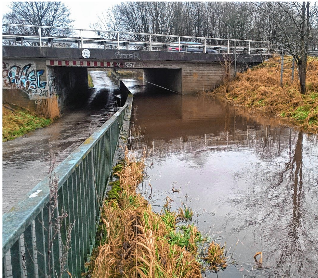
Die Ekholter Au fließt in Seeth-Ekholz unter der A23 her. Vor zwei Wochen war der Wasserstand ungewöhnlich hoch. Das Bild zeigt, dass nicht mehr viel Luft nach oben ist. BEIERSDORF
